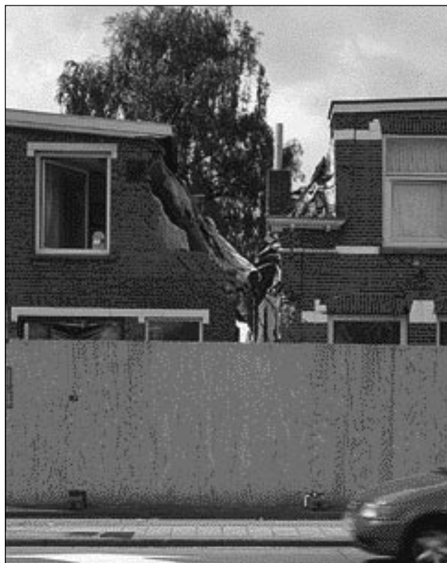
Figur 2. Hus-skador av kringflygande betongblock. Dessa hus låg flera hundra meter från explosionscentrum.
